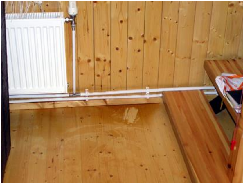
FOTO 3. Eostolm koridori põrandal. Paremäl näha tolmuproovi võtmise jälgi.
